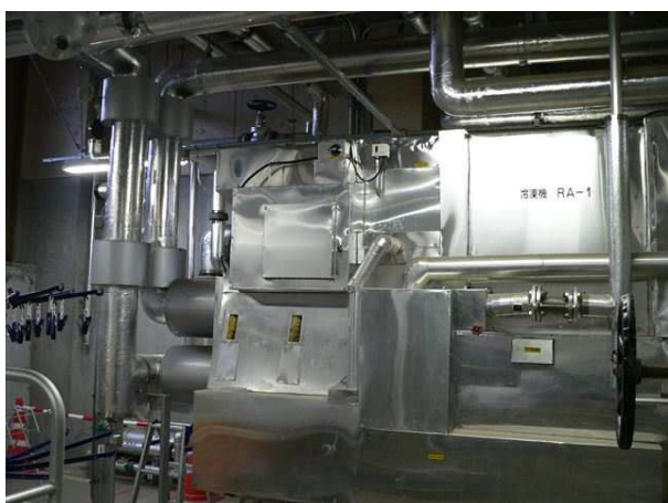
③ 冷凍機(全館の冷房を担っています)
