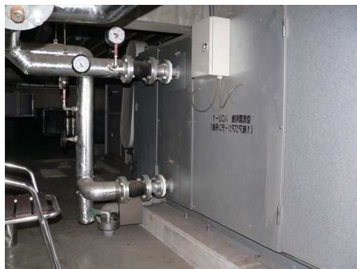
⑧ プール室の暖房用の空気調和機
