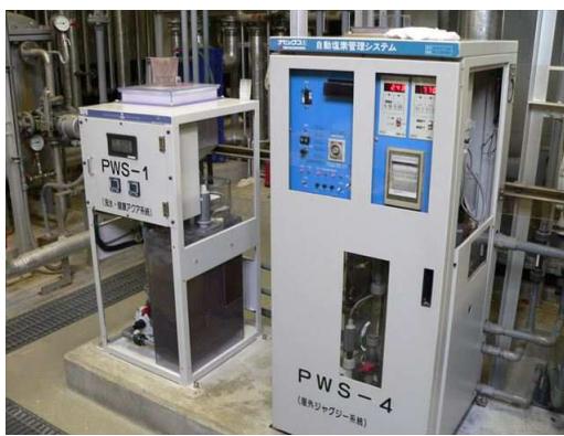
⑤ 自動塩素供給装置(各プールに塩素を供給します)
