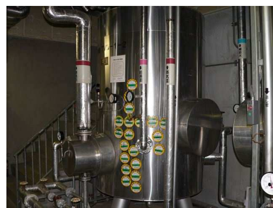
④ 貯湯槽(シャワーや水道のお湯を作ります)
