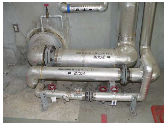
① 新田清掃センターから送られてきた蒸気の取り込み口
